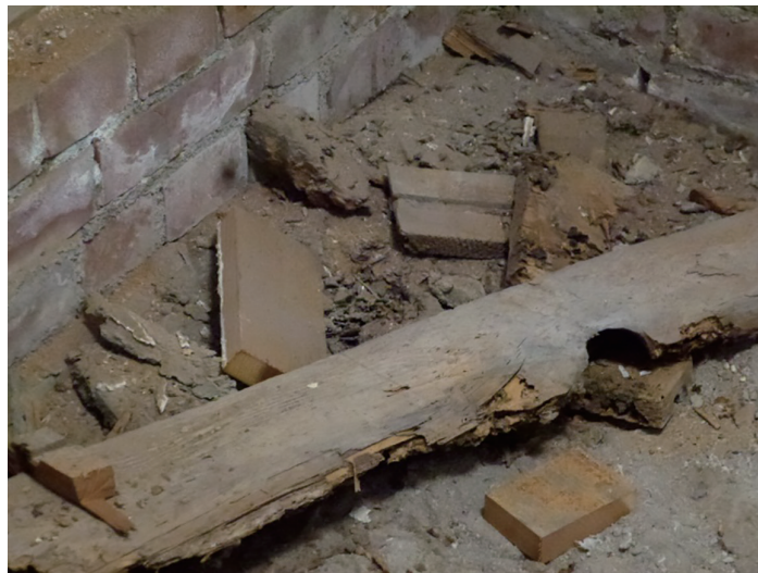
図-2 談話室 床下材木の腐食
