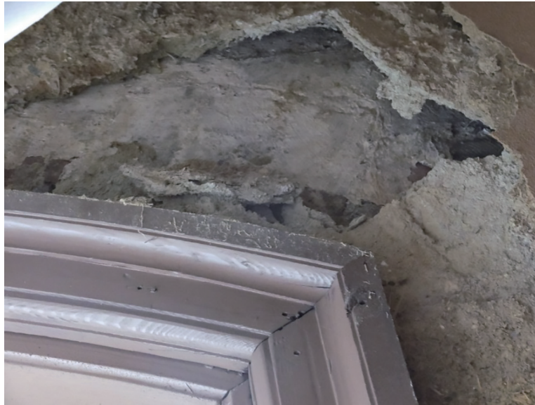
図-3 窓枠の右上 天井および壁の剥落
